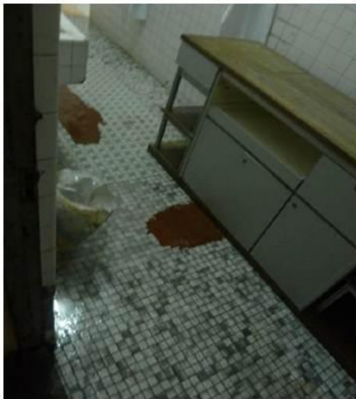
製作區地板破損
