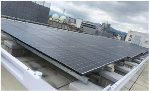
太陽光発電パネル（新水産棟）
