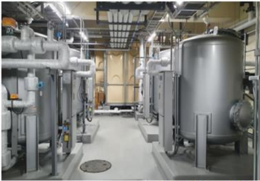
地下水処理設備（新水産棟）
