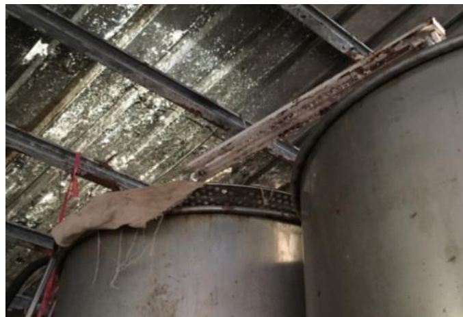
燈具生鏽損壞仍未更換
