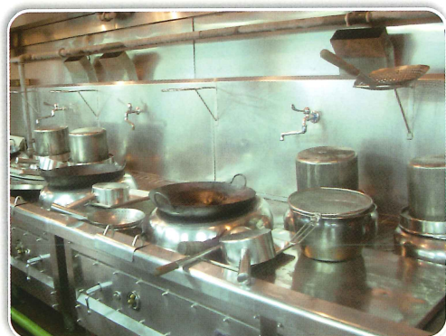
5-20 爐灶標準配備放置
